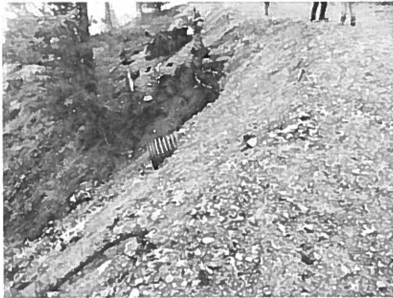
Foto 31: Rientro Gimont - drenaggio
