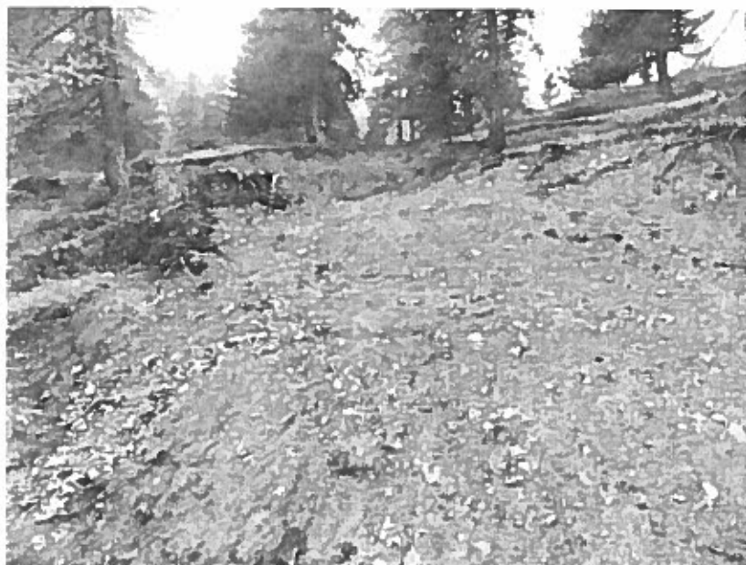
Foto 34: Rientro Gimont - dissesto a monte del tracciato
