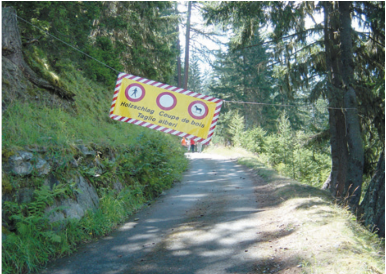
Figura 2.12 - Durante i lavori di abbattimento ed esbosco la viabilità silvo-pastorale può essere interdetta al traffico veicolare e pedonale per motivi di sicurezza (Kippel, Lötschental - CH).
