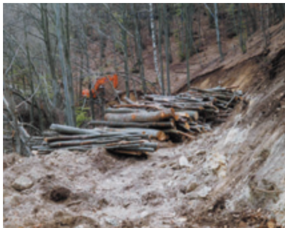
Figura 5.13 - Accatastamento temporaneo di legna da ardere durante le fasi di apertura di una pista (Valle Maira – Cn).
