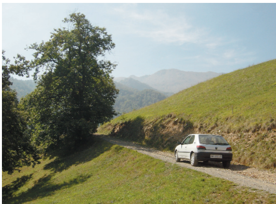
Figura 7.1 - Le scarpate di monte costituiscono uno degli aspetti che richiede maggior cura nella realizzazione di opere di viabilità silvo-pastorale. Il loro mancato rinverdimento può essere causa di innesco di fenomeni erosivi e rende la visuale dell'opera meno gradita. (Alta Valle Elvo– Bi).
