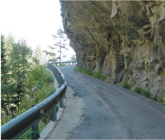
Figura 7.4 - Nelle aree alpine la viabilità pubblica in alcuni casi deve essere costruita secondo un percorso ardito e con dovizia di opere di sostegno e barriere di protezione (Valle del Sempione – Vb). Il rispetto dei requisiti previsti dalla normativa tecnica è allora un passaggio obbligato nell'iter progettuale dell'opera (cfr. § 7.2). La viabilità agro-silvopastorale, che in genere affronta percorsi meno problematici da un punto di vista costruttivo e geomorfologico, può derogare da tali norme, che rimangono tuttavia un punto di riferimento.
