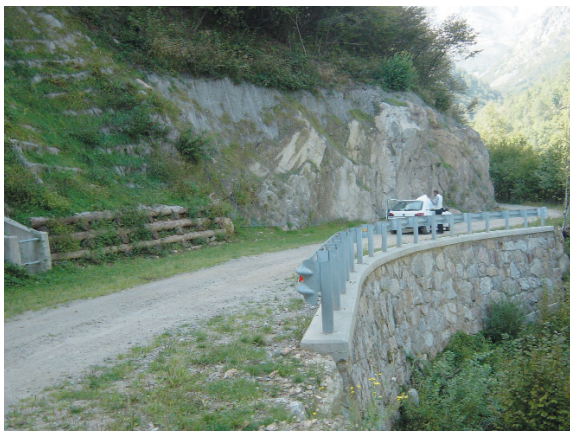
Figura 7.5 - Opere di consolidamento e di sostegno del corpo stradale realizzate con differenti soluzioni costruttive (sopra strada palificate a doppia parete, sotto strada scogliere) lungo una strada di pubblico transito in ambiente pedemontano (“tracciolino” – Bi).
