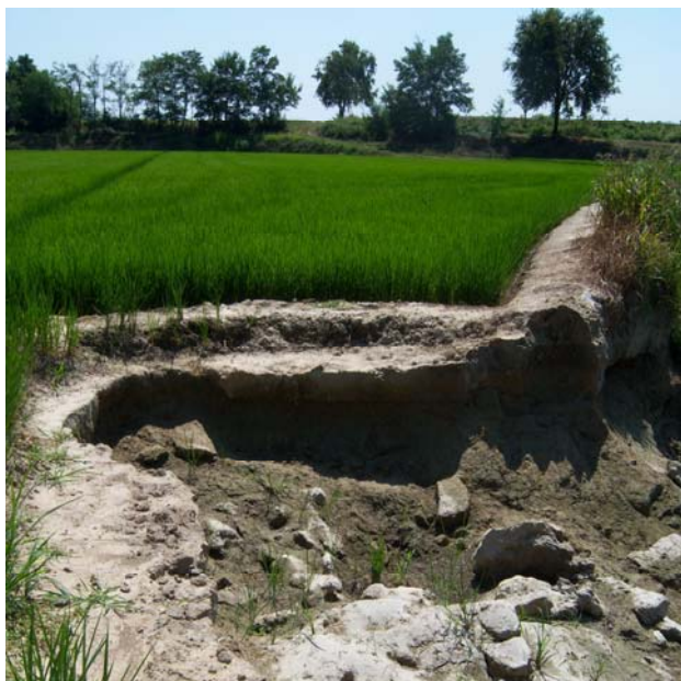
Il danno della Nutria alla canalizzazione artificiale può comportare ingenti interventi di ripristino
