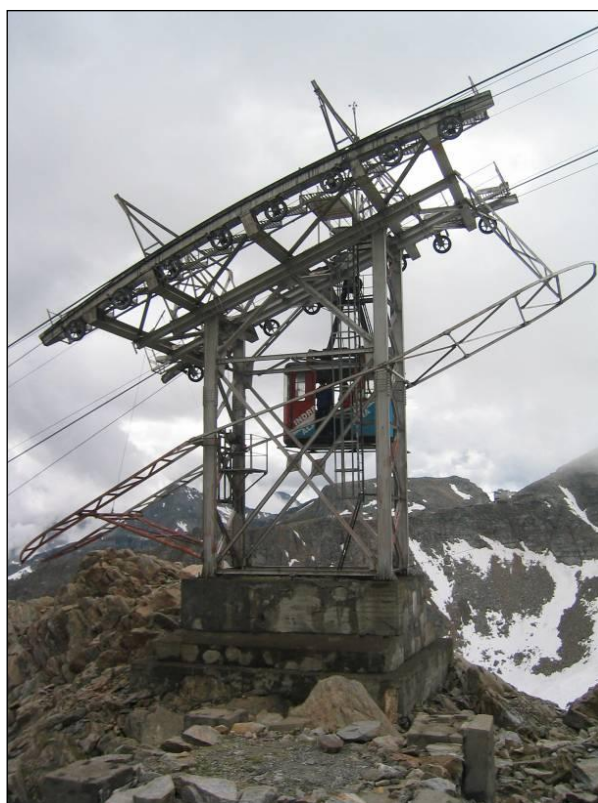
Figura 4.1.14/2 Funivia di Punta Indren – Sostegno Dente Bors
