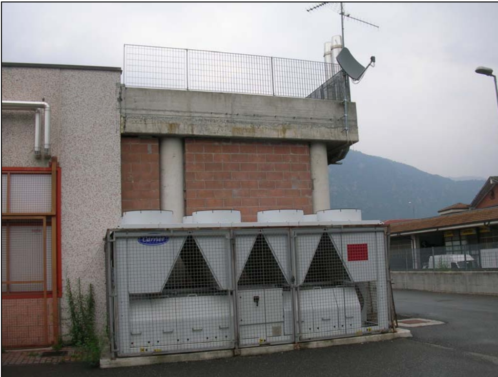
Figura 5: Impianti posti sul retro della rampa di salita al parcheggio
